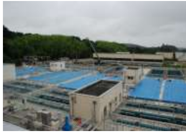
須江山浄水場
