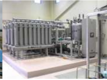
雄勝地区原浄水場膜ろ過装置
