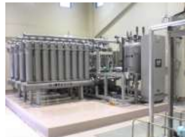
雄勝地区原浄水場膜ろ過装置
