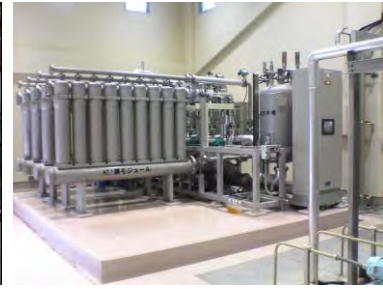
雄勝地区原浄水場膜ろ過装置
