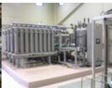
雄勝地区原浄水場膜ろ過装置
