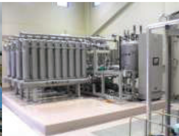
雄勝地区原浄水場膜ろ過装置
