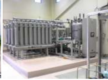
雄勝地区原浄水場膜ろ過装置
