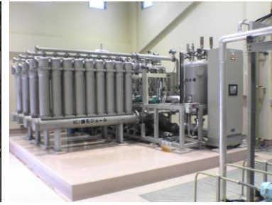
雄勝地区原浄水場膜ろ過装置
